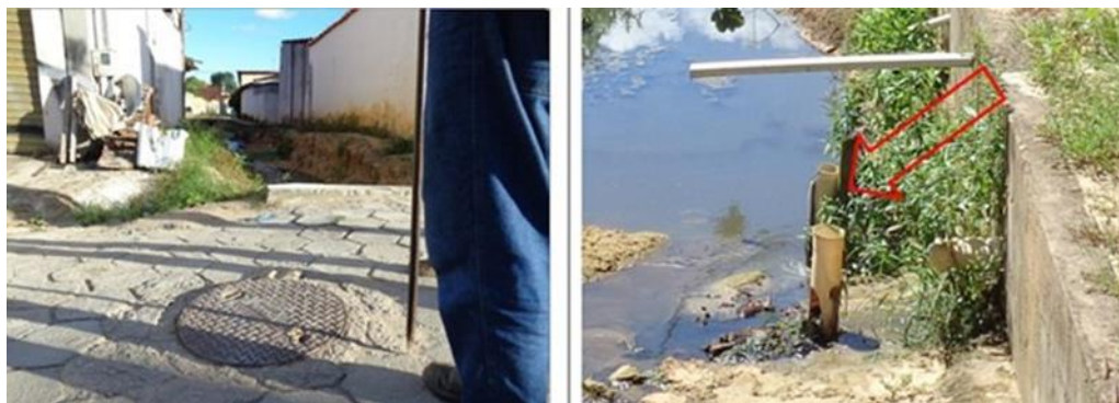
Figura 6. Esgoto a céu aberto em Santa Helena de Minas (MG).
